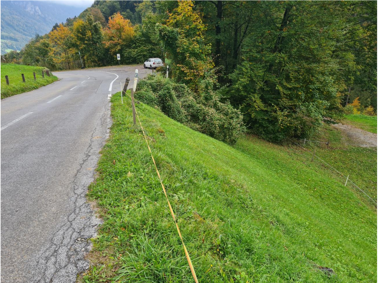
Abb. 3: Abgedrückter Fahrbahnrand auf weite Strecken (Foto: M. Ammann 05.10.2025)
