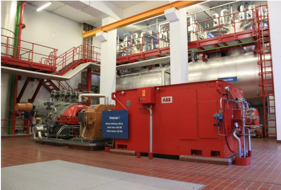
Die Maschinengruppe der Ofenlinie 1 der KVA Linth
