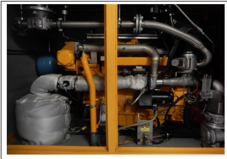
Einer der drei Gasmotoren der Kläranlage Glarnerland
