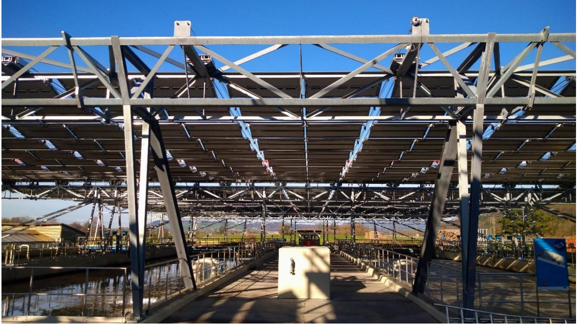
Grösste Photovoltaikanlage in Glarus Nord: Kläranlage Bilten: 818 kW
