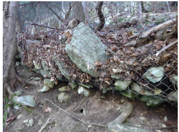
Stark verfüllter Maschendrahtzaun
