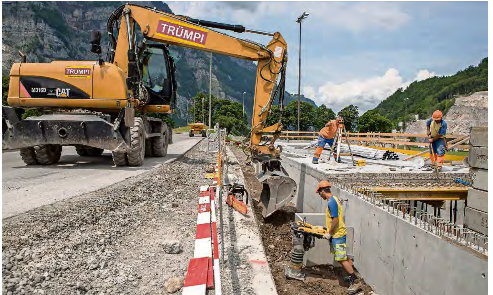
Es geht voran: Wenn die Hinterfüllungen bei der Tribüne abgeschlossen sind, werden die Belagsarbeiten an der Leichtathletikbahn in Angriff genommen.
