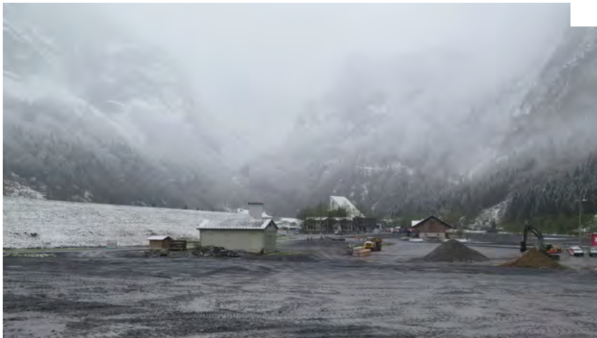
Baustelle Linth Limmern: Auf dieser Fläche soll der alte Boden aufgetragen werden und bald wieder Gräser wachsen. SRF / PETER SCHÜRMAN
