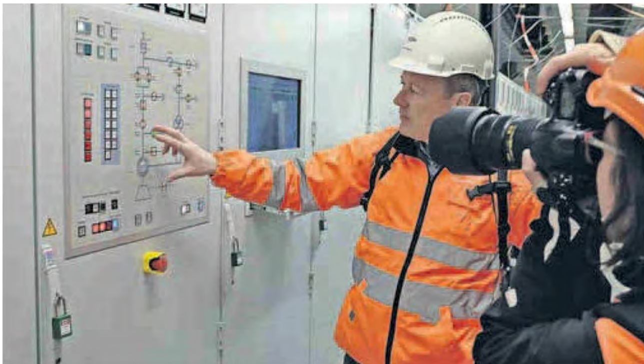
Bei der Inbetriebnahme der ersten Maschine erklärt Rolf W. Mathis die Schaltung des Pumpspeicherwerks Limmern.
