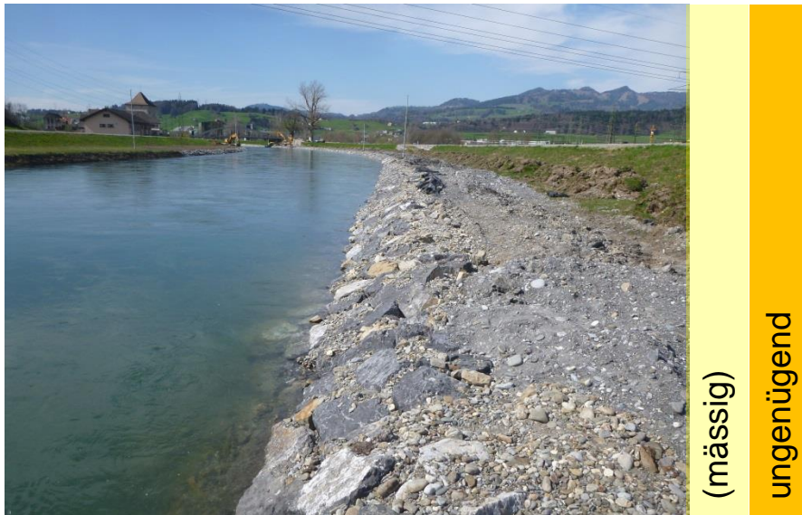
Abb. 20 Neu erstellte Blocksatz-Verbauung oberhalb Grytau rechtsufrig, Foto J. Guthruf.
