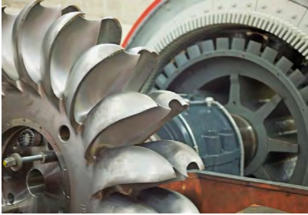
Eine der Turbinen des Kraftwerks Linth-Limmern. Keystone
