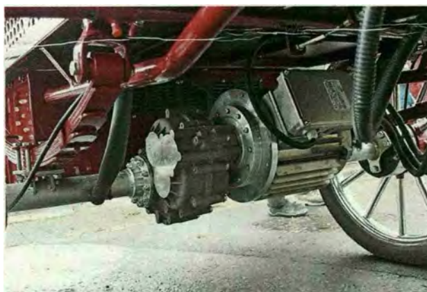
Viel Elektrotechnik steckt unter der Kutsche.
