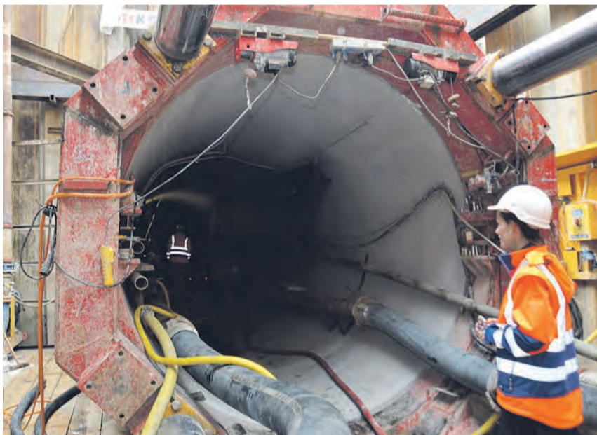
Blick in eines der hohen Rohr-Elemente der Cotlan in Linthal.
