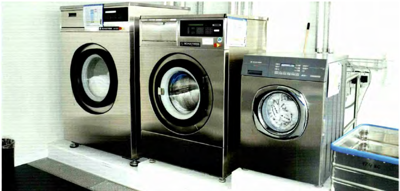
La blanchisserie du nouveau centre Mühleareal de la fondation Glarnersteg à Schwanden a été conçue pour garantir des déroulements de travail optimaux. Les appareils modernes ménagent le linge et consomment moins d'eau et d'électricité.
