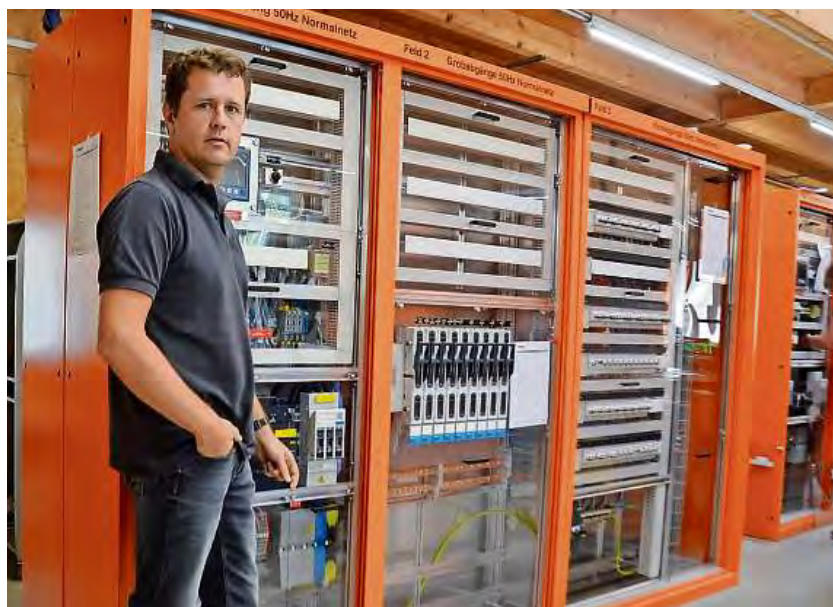
Stolz: Projektleiter Thomas Elmer vor einem bei der Firma Oswald Electronic fertiggestellten Schaltschrank.
