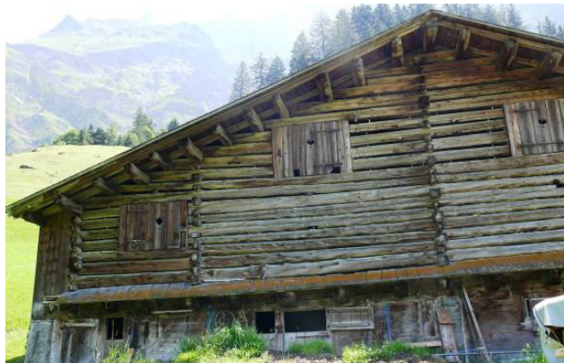
Abb. 180: Elm, Jetzberg. Eng liegende Pfetten (Chatzbäume) eines breiten Doppelstalls mit firstteilender Binnenlängswand. Dachhaut modern.
