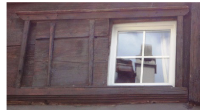
Abb. 48: Ennetbüels, Dörflistrasse. Neues Sprossenfenster in historischem Rahmen. Der unten durchziehende Rillenfries belegt die bauzeitliche Fensteranordnung.
