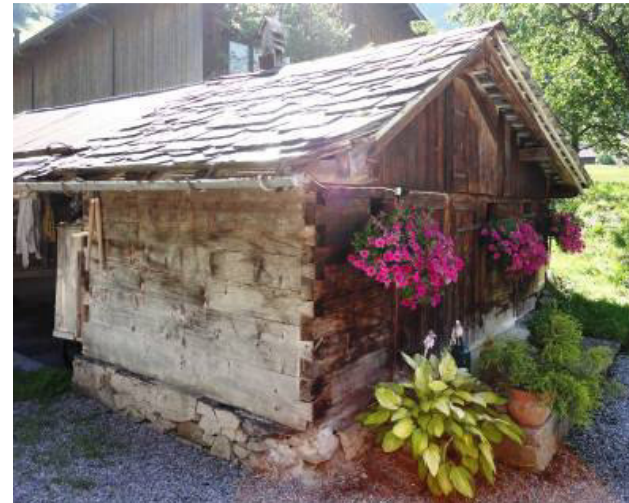
Abb. 191: Matt, Auen. Gezinkter Block auf gemau-ertem Sockel. Mit zwei Stallabteilen und Schieferplat-tendeckung. 2013 abgebrochen.
