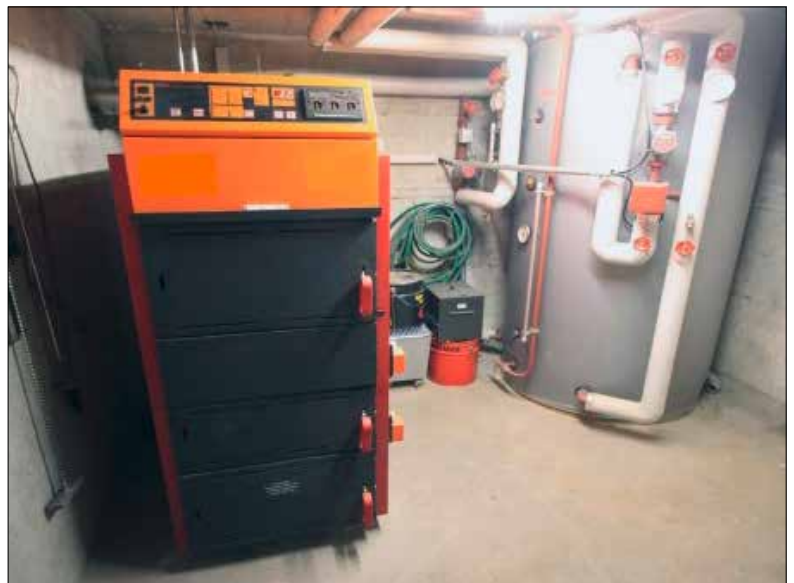
Messpflichtige zentrale Holzfeuerung mit einer Leistung von weniger als 70 kW (AUE).
