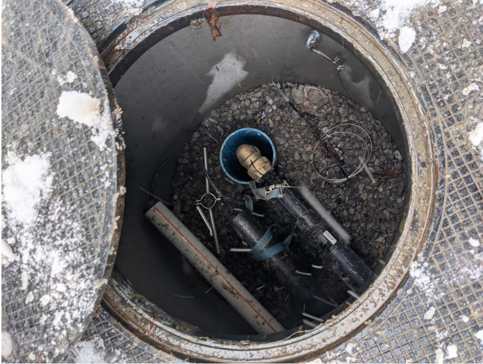
Abbildung 8: Grundwasser Wärmepumpen Schacht
