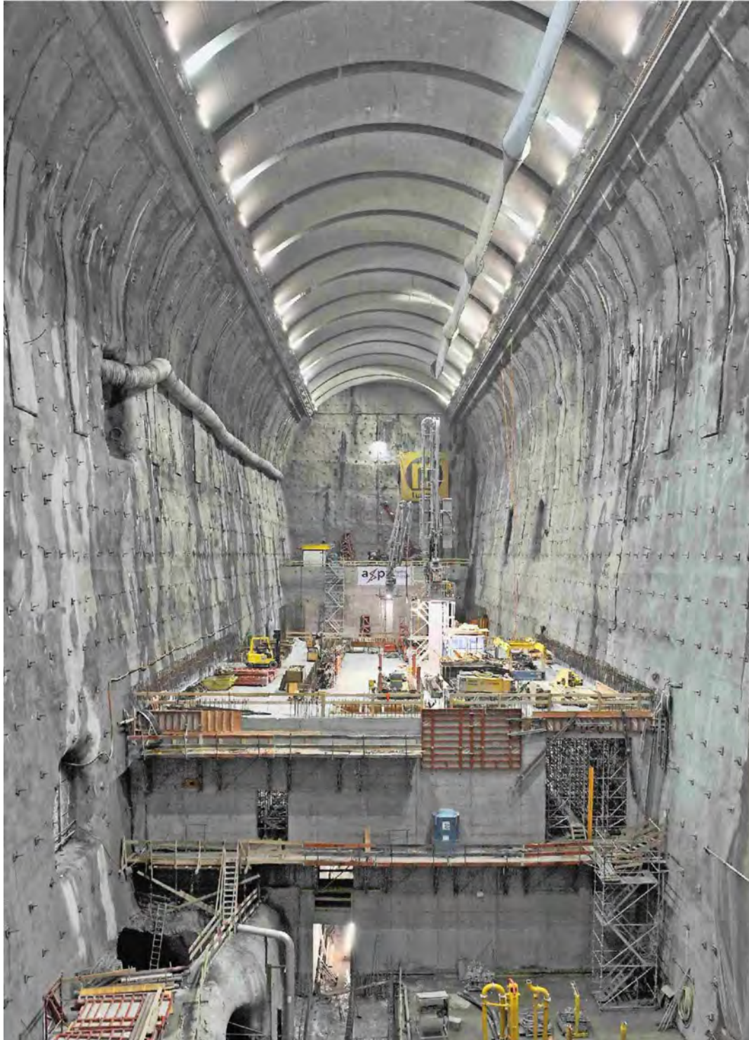
So gross wie die Zürcher Bahnhofshalle: Die beiden Kavernen bieten Platz für je vier Transformatoren und Turbinen
