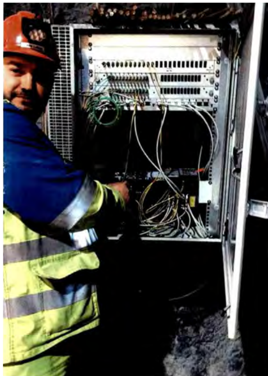
In allen 300 Notrufstationen sitzen Netzteile und Stromversorgungen von Puls
