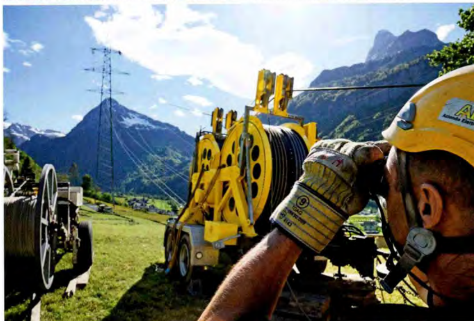
Kontrollierter Ablauf: Damit das Nylonseil nicht zu schnell von der Seiltrommel läuft, benutzt Norberto Stucchi ein Holzbrett als Bremse (oben). Dieselbe Aufgabe übernimmt beim Einziehen der Leiterseile die Bremsmotorrolle (unten). Chefmonteur Heiri Rhyner überprüft mit dem Feldstecher, ob die Leiterseile ausreichend gespannt sind
