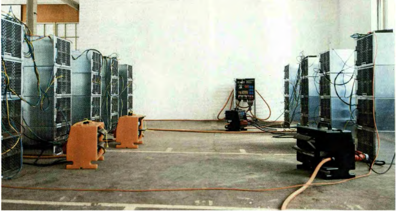
Serverraum in Linthal: Strom in Bitcoins umgewandelt.
