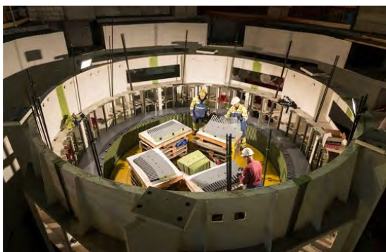
Hier entsteht bald Strom: Arbeiten an einem Generator in der Kaverne des Kraftwerks Linthal. Christian Beutler/Keystone
