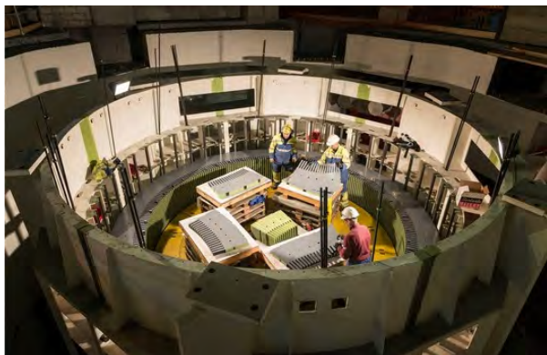
Hier entsteht bald Strom: Arbeiten an einem Generator in der Kaverne des Kraftwerks Linthal. Christian Beutler/Keystone
