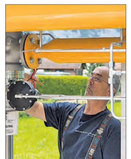
Kontrollgang in der neuen DRM-Station Rollengut in Netstal.
