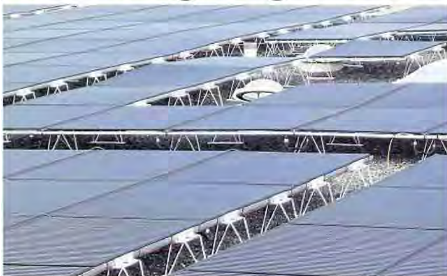
Die Energieallianz baut Photovoltaikanlagen mit Bürgerbeteiligung. Bild: Ann-Kristin Peterson
