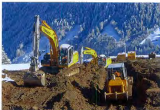
Erst im Oktober fuhren die Baumaschinen auf. Trotz der sehr kurzen Bauphase konnte die neue Kinder-Arena auf Ämpächli pünktlich am 22. Dezember 2012 eröffnet werden.
