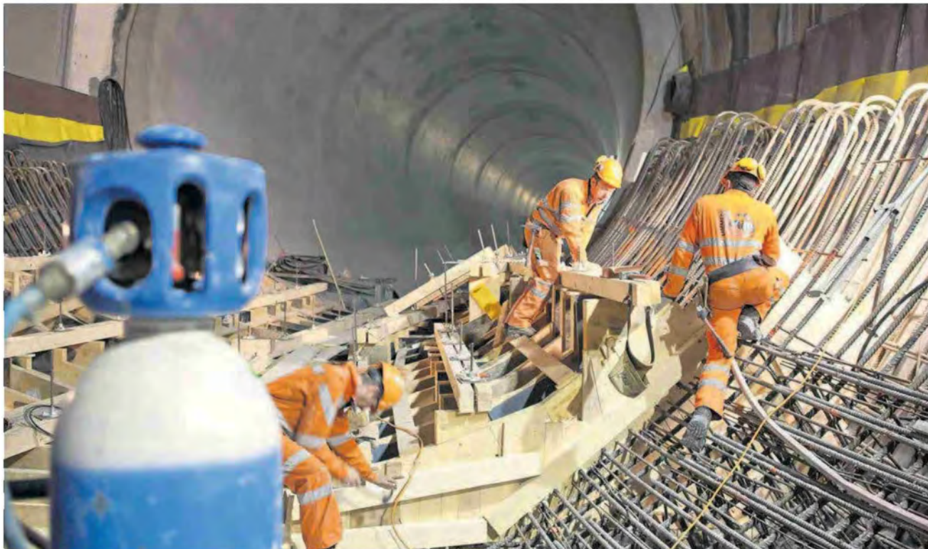
Enorme Dimensionen. Die 1051 Meter langen Druckschächte werden mit dicken Stahlrohren ausgekleidet. Foto Michael Breu
