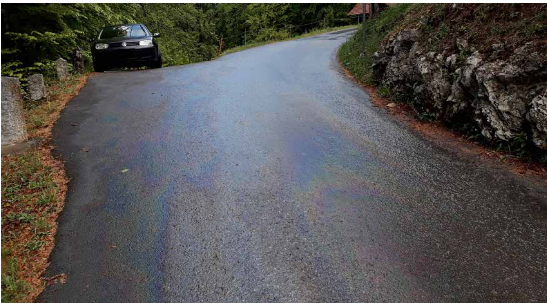
Ölverschmutzung über ca. 2 km Länge aufgrund einer Havarie eines PW's mit einem Stein auf der Fahrbahn
