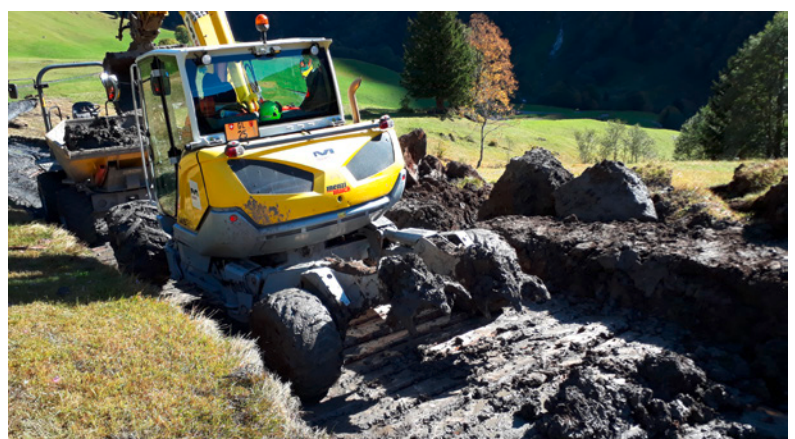
Für die Erstellung der Ersatzerschliessung Krauchthal werden zur Querung eines Feuchtgebietes Holzpfähle als Träger für die Strasse verlegt.
