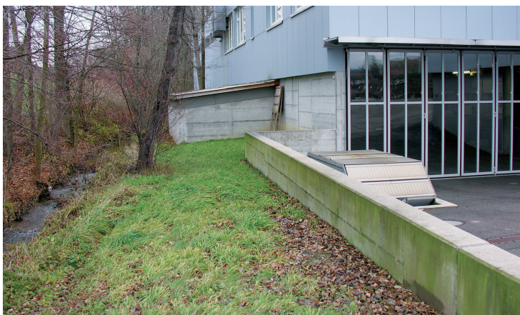
Hochwasserschutz für Chemikalienlager (Bildquelle: Amt für Umwelt, Kt. TG)
