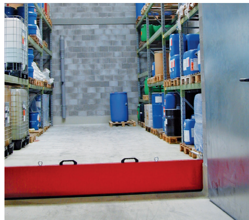
Leckage-/Löschwasserrückhalt (Bildquelle: Amt für Umwelt, Kt. TG)
