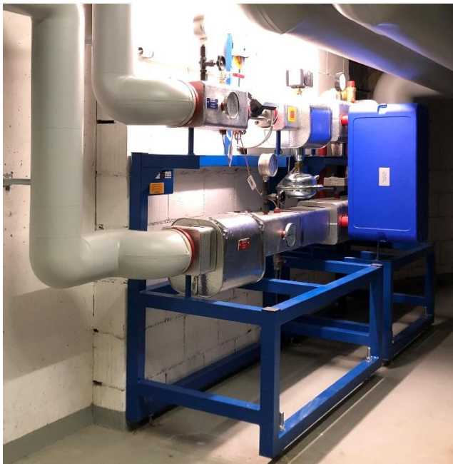
Abbildung 8: Übergabestation Fernwärmenetz für ein Industriegebäude
