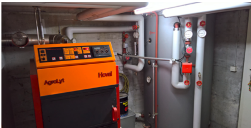
Zentrale Holzfeuerung mit Speicher (AUE)
